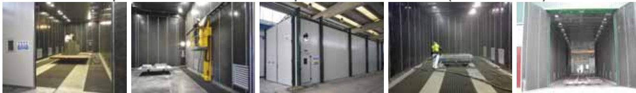
Collocazione interno fabbricato con raschiatori e coclea
