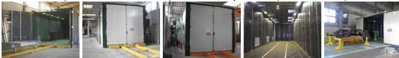
Collocazione interno fabbricato con basamento e binario
