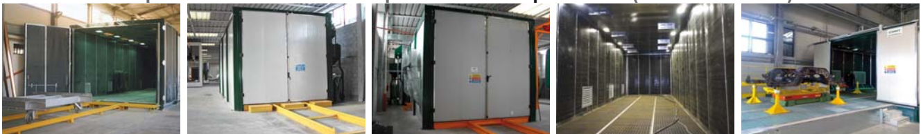
Collocazione interno fabbricato con basamento e binario
