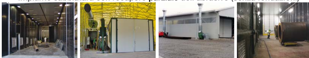
Collocazione interno fabbricato con tramoggia di carico fuori pavimento (a pala)
