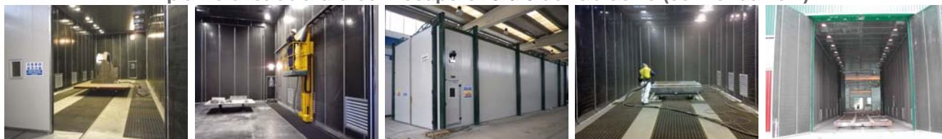
Collocazione interno fabbricato con raschiatori e coclea
